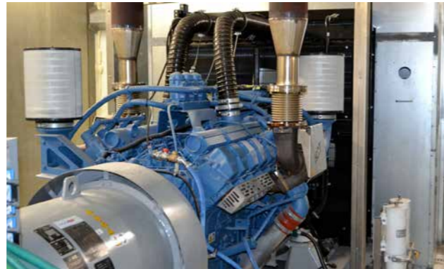
Á støðini eru 15 neyðstreymgeneratorar – fimm teir størstu við einum kapasiteti á 1200 amperur hvør
