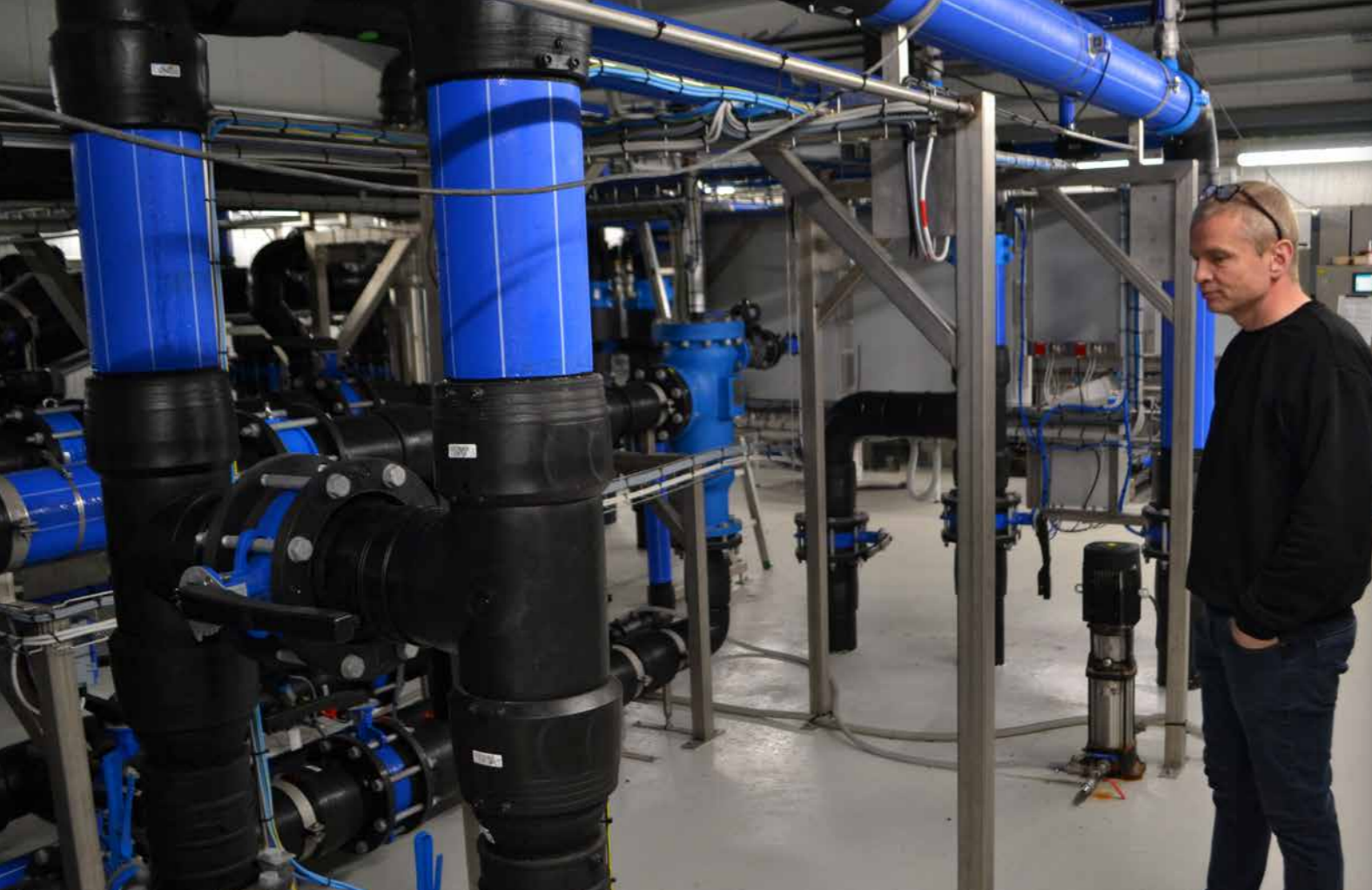
Ein stórir partur av arbeiðinum hjá maskinmeistarunum er at fylgja við pumpuskipanum til alikørlini
