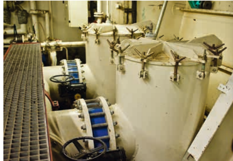
Sjógvfiltur til pumpurnar, sum pumpa sjógv upp í skrubbararnar
