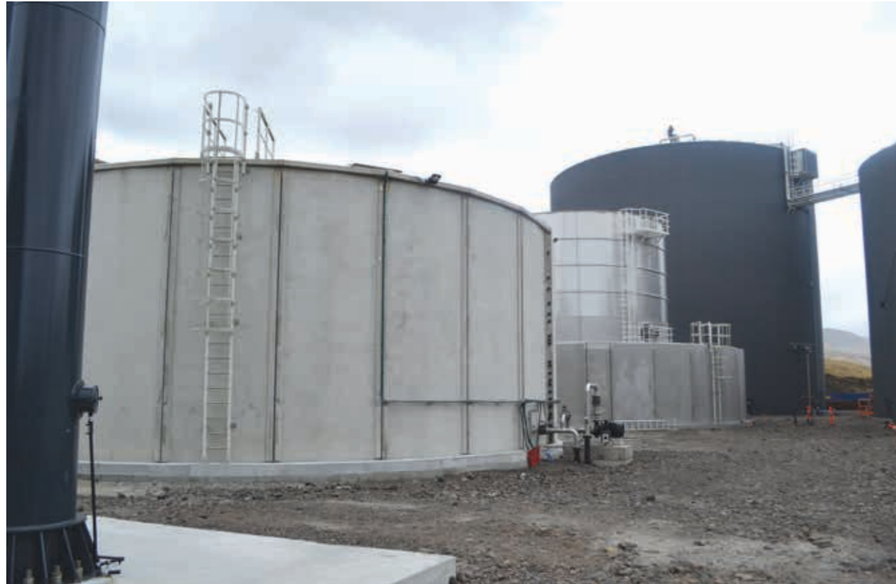
Stóri framleiðslutangin er 9000 kubikk. Frammanfyri stendur tangin til súrlög, sum av trygðarorsøkum stendur uppi í einum øðrum tanga
