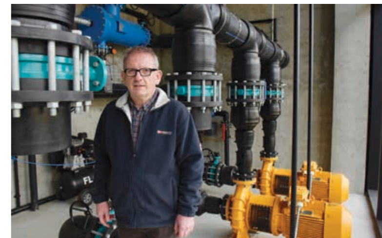
Jóhan við Neyst inni í Sjóhitastøðini. Høgrumegin síggja við gulu pumpurnar, sum pumpa sjógv inn í skipanina, og uppi yvir honum síggja vit tað eina bláa filtrið, sum reinsar sjógvin
